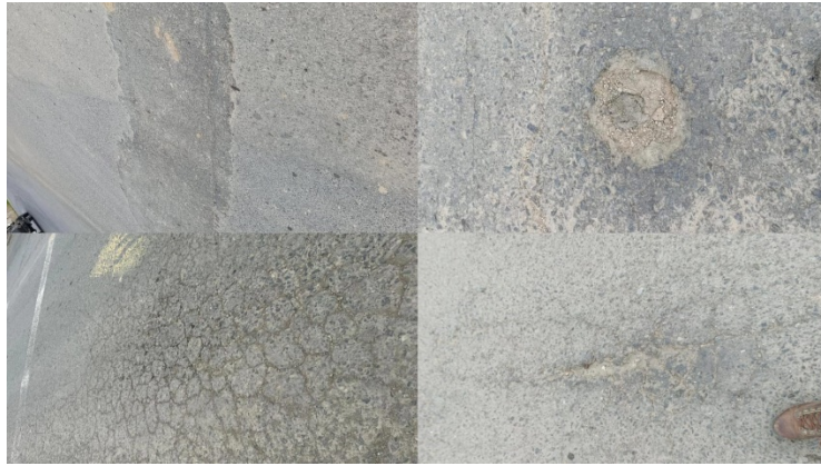
Figura 2: Fallas encontradas durante la inspección visual.
