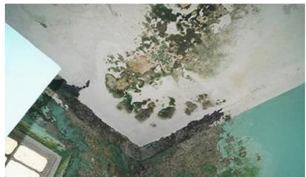
Figura 2. Moho y manchas de humedad en techo y muros
