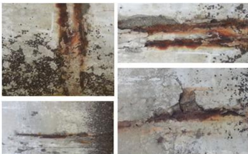
Fig. 3. Delaminación del recubrimiento del hormigón por acción corrosiva
