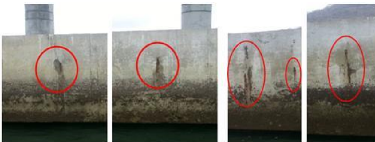
Fig. 2. Fenómeno corrosivo evidente en varios tramos del puente
